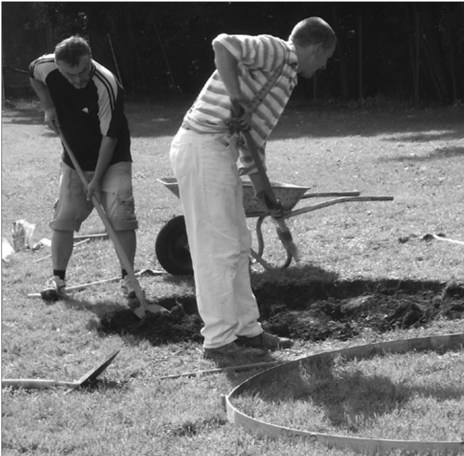
Bruno Müller und Matthias Klemens beim Ausheben der Baugrube für den neuen Kugelstoßkreis (Bild: Sebastian Müller)
